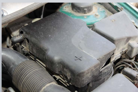
Аккумуляторная батарея закрыта сверху пластиковой крышкой. Верхняя поверхность АКБ не загрязняется, и, следовательно, снижается вероятность саморазряда
