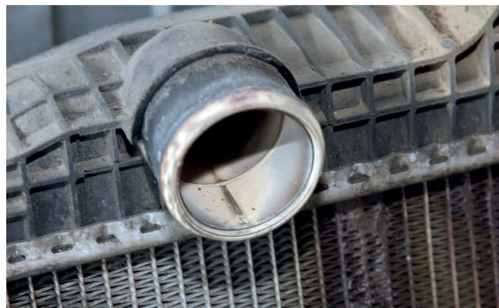
▲ По наличию отложений различного характера на внутренней поверхности патрубков можно косвенно судить о состоянии агрегатов системы охлаждения. Отложения любого типа затрудняют теплоотвод
